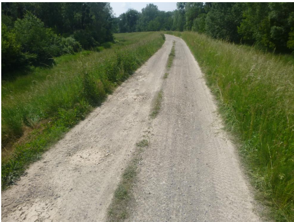
Obr.3 k.ú. Boťany – vedenie cestičky pre cyklistov po korune protipovodňovej hrádze rieky Latorica km 6,000 variant červený - pokračuje po PBH Latorica na západ v smere obec Boťany
